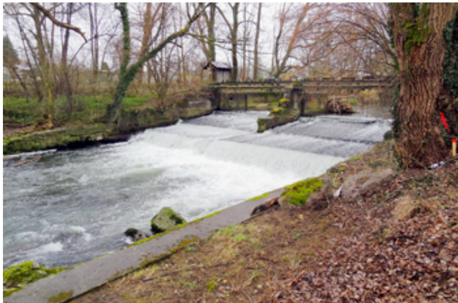
Wehr Lochergrien: unüberwindbare zwei Meter. Auch sprungstarke Forellen können hier nicht weiter!
